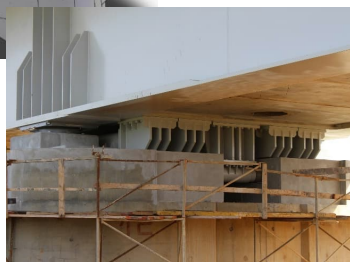
Pila centrale del viadotto El Hachef, Marocco. Dispositivi installati: 4 ISOSISM® PDS longitudinali, 2 ISOSISM® PDS trasversali, 1 ISOSISM® FD trasversale e 2 appoggi TETRON® CD GL multidirezionali
