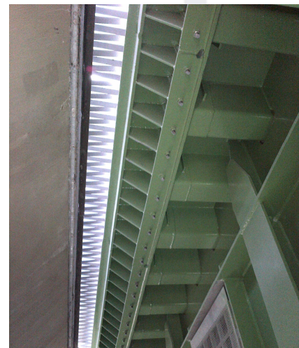
WP550 installato su un ponte a piastra ortotropa, Szébény (Ungheria)
