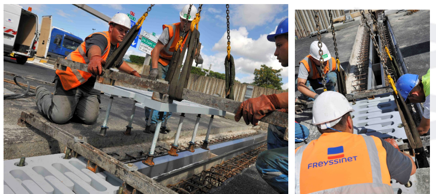
Autostrada A71 (Francia) installazione di WP250
